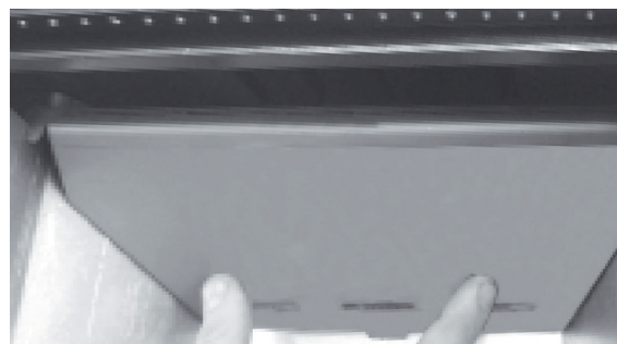
Fig. 14: elevador do defletor de chama
