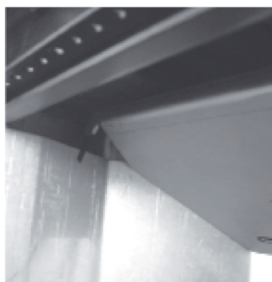
Fig. 15: elevador do defletor de chama
